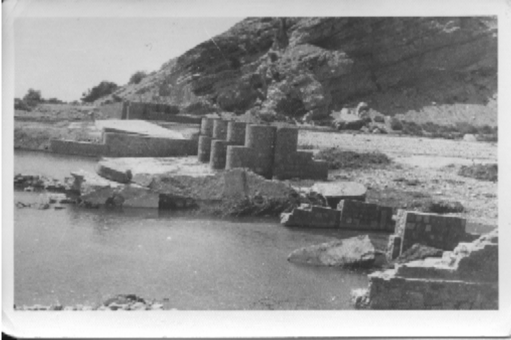
صورة : 12 أطلال حاجز باتيس التحويلي (وادي بناء ، محافظة / ابين) بعد أن جرفته السيول في نهاية ثمانينيات القرن الماضي
